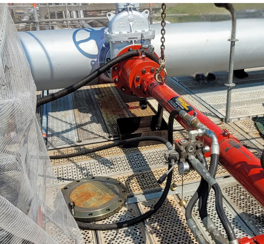
Piquage en charge DN400 sur collecteur d'essence DN700 / DN400 Loaded Fuel Tap on DN700 Fuel Collector
