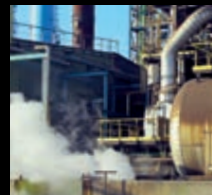
Fuite sur réseau vapeur
