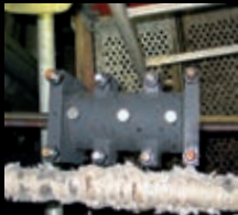
Boîte sur tuyauterie
